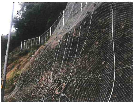
対策状況(防護網と防護柵(上))
